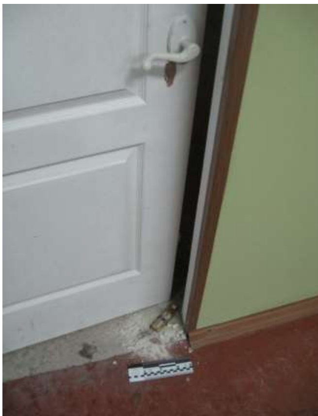
Фото № 9 Зовнішній вигляд дверей з ознаками злому.
